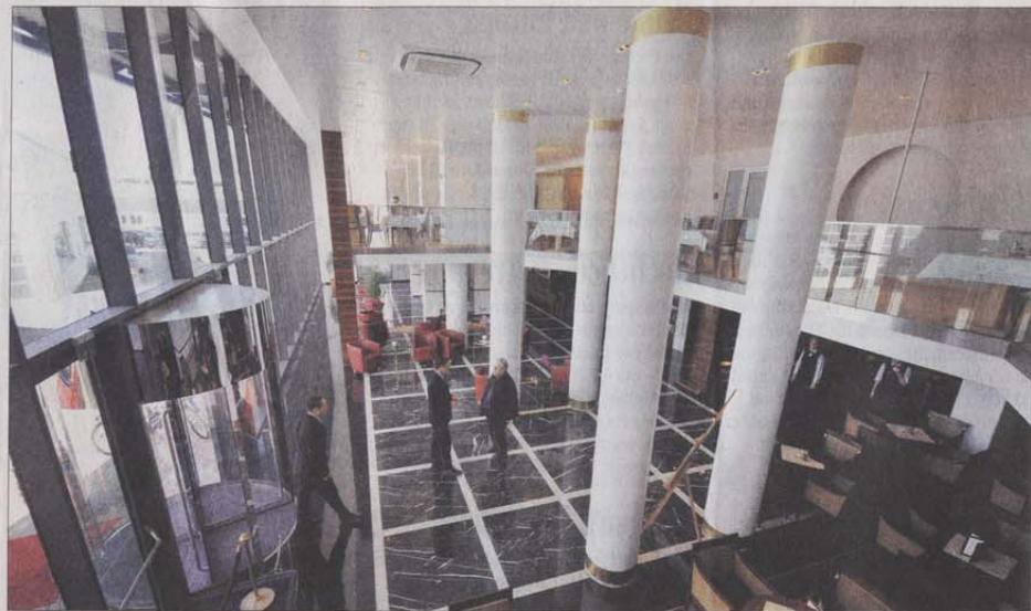
Noch laufen die Bauarbeiten: das neue Foyer des Hotels „Stadt Freiburg“ nimmt Gestalt an.
